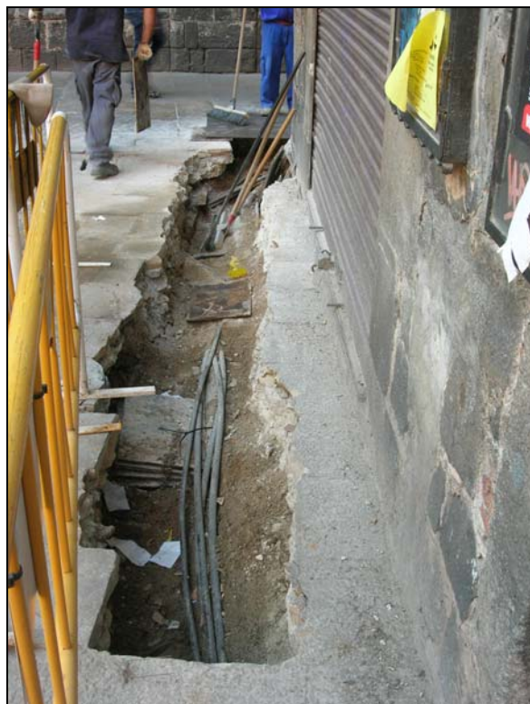
29. Tram de rasa al C/ Cardenal Casañas- la Plaça del Pi., serveis.
